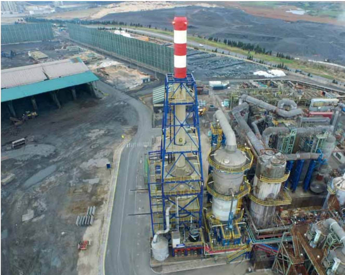
Uno de los principales proyectos implementados por Codelco Ventanas, previa entrada en vigencia de la normativa de gases en el año 2018, fue la construcción de la Planta de Tratamiento de Gases de Cola, donde se realiza el procesamiento de gases resultantes de la producción de ácido sulfúrico y su abatimiento de SO 2 .
