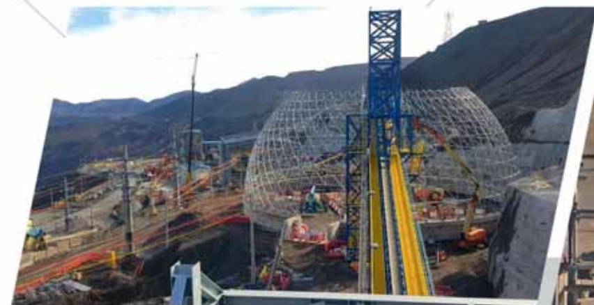
Codelco El Teniente, Construcción Planta de Escorias de Convertidores, VI Región, Chile.
