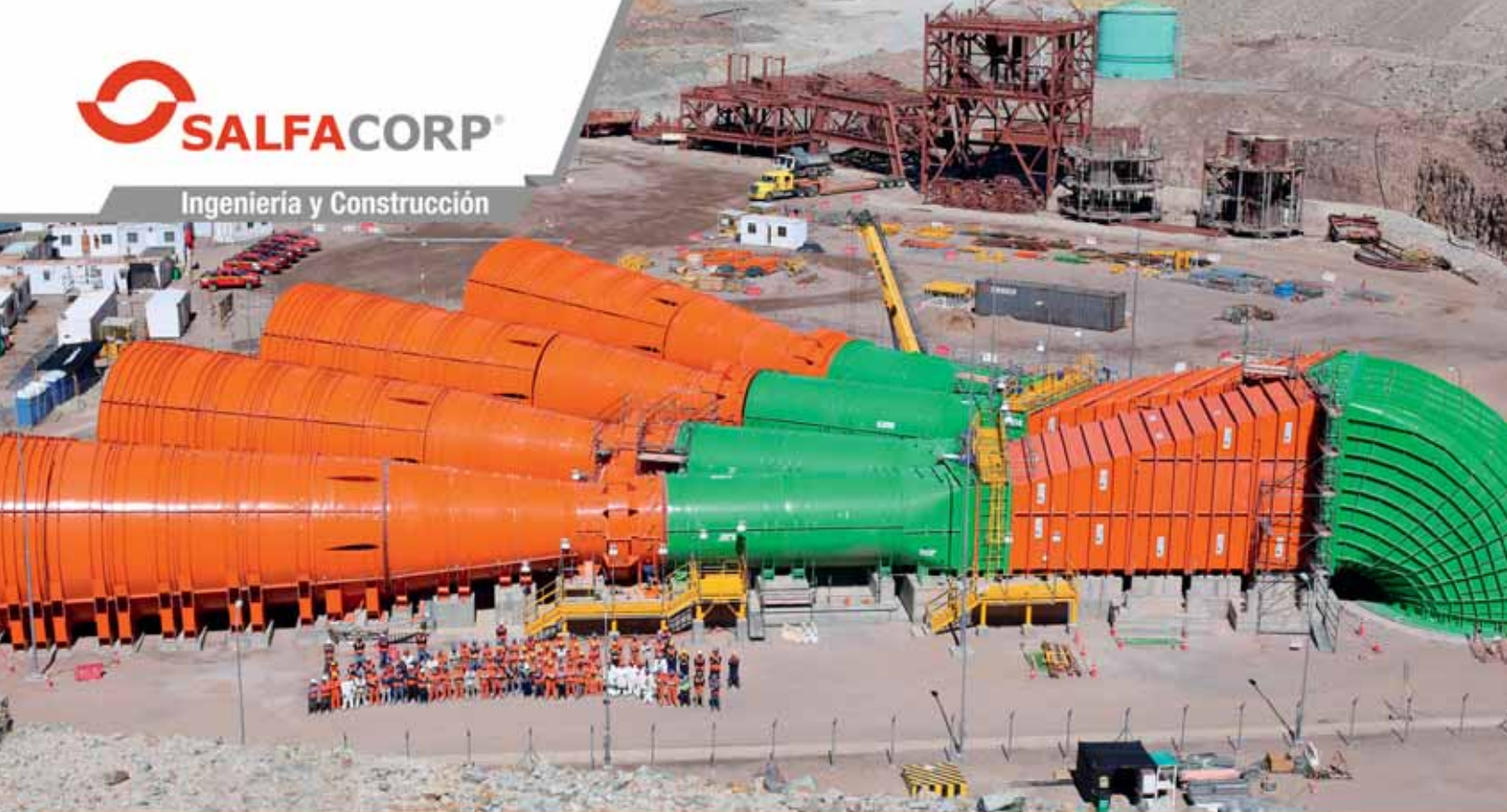
Codelco - Chuquicamata Subterránea, Obras Civiles y Montaje de Ventiladores Principales de Extracción e Inyección, Il Región de Antofagasta, Chile.
