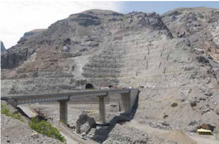
■ Una de las novedades a nivel de técnicas constructivas, es el precondicionamiento aplicado a túneles a través del hidrofracturamiento.
