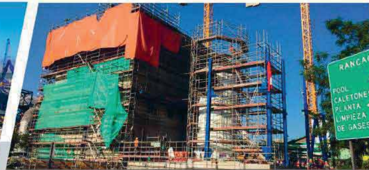
Codelco El Teniente, EPC Reducción de Emisiones Planta de Limpieza de Gases Fundición Caletones, VI Región, Chile.
